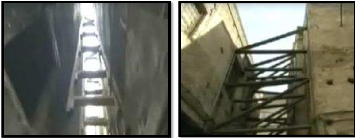
Fig.12 : des étaielements contre l'affaissement des murs Source : l'émission française: des racines et des ailes
